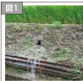
図1 モグラが空けた穴からの漏水
